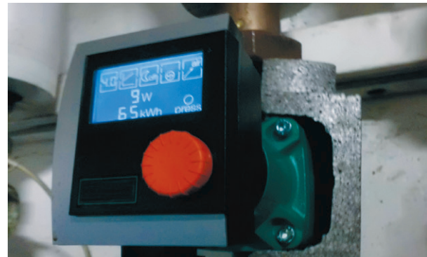
Diese Hocheffizienzpumpe läuft im Moment der Aufnahme mit einer Leistung von neun Watt.
