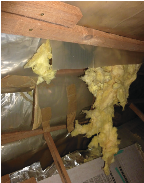
Hier ist nichts luftdicht – es besteht Handlungsbedarf.
