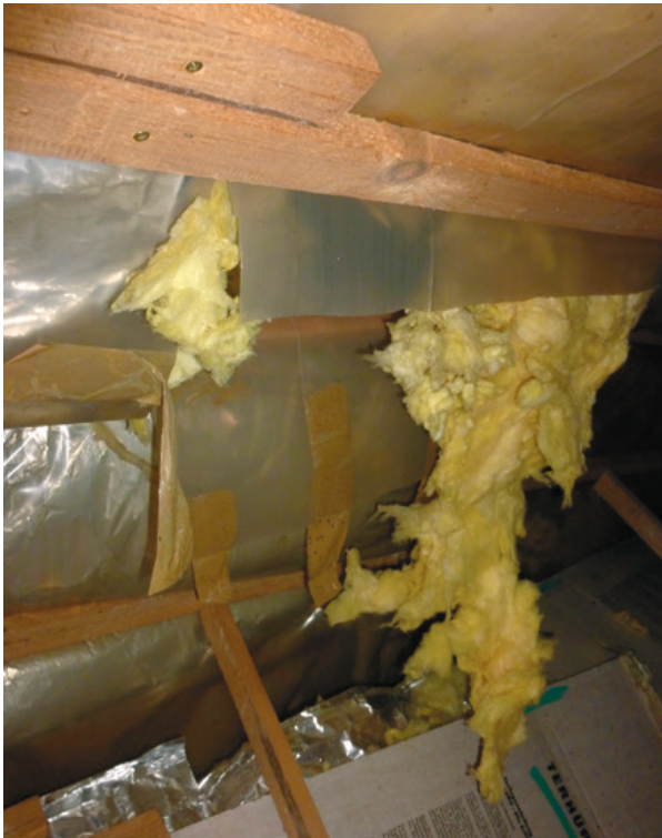
Hier ist nichts luftdicht – es besteht Handlungsbedarf.
