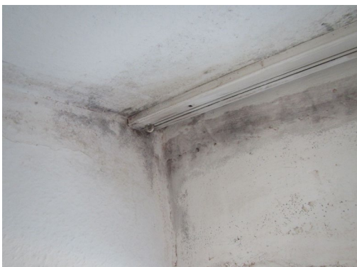
Abbildung 1: Schimmel in der oberen Raumecke, Foto: Martina Rittersdorf
